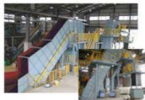
破碎プラント
